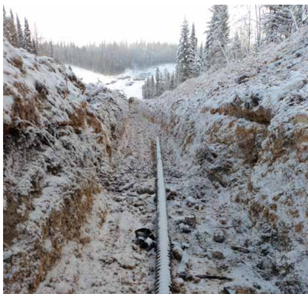
Sheltons fältpipeline från brunn till faciliteter
