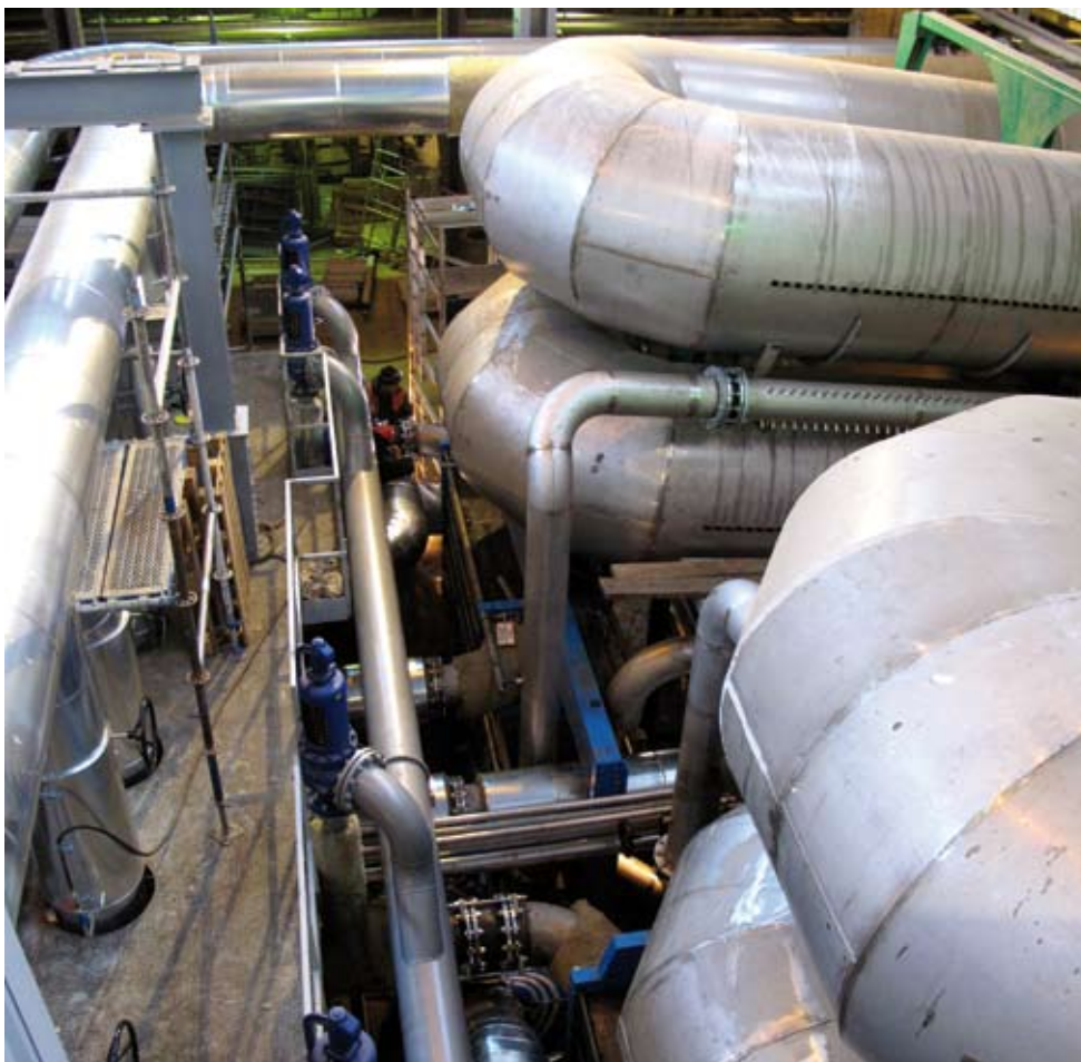
Installationsarbeten vid fjärrvärmeverket i Litauens huvudstad Vilnius, där Opcon Bioenergy, OBE (tidigare Svensk Rökgasenergi) konstruerat anläggningen och samarbetar med litauiska specialistföretaget Axis Industries om tillverkning och montage. Opcon Bioenergy har en partnerstrategi som innebär ett nära samarbete med kvalificerade lokala företag på varje geografisk marknad.
