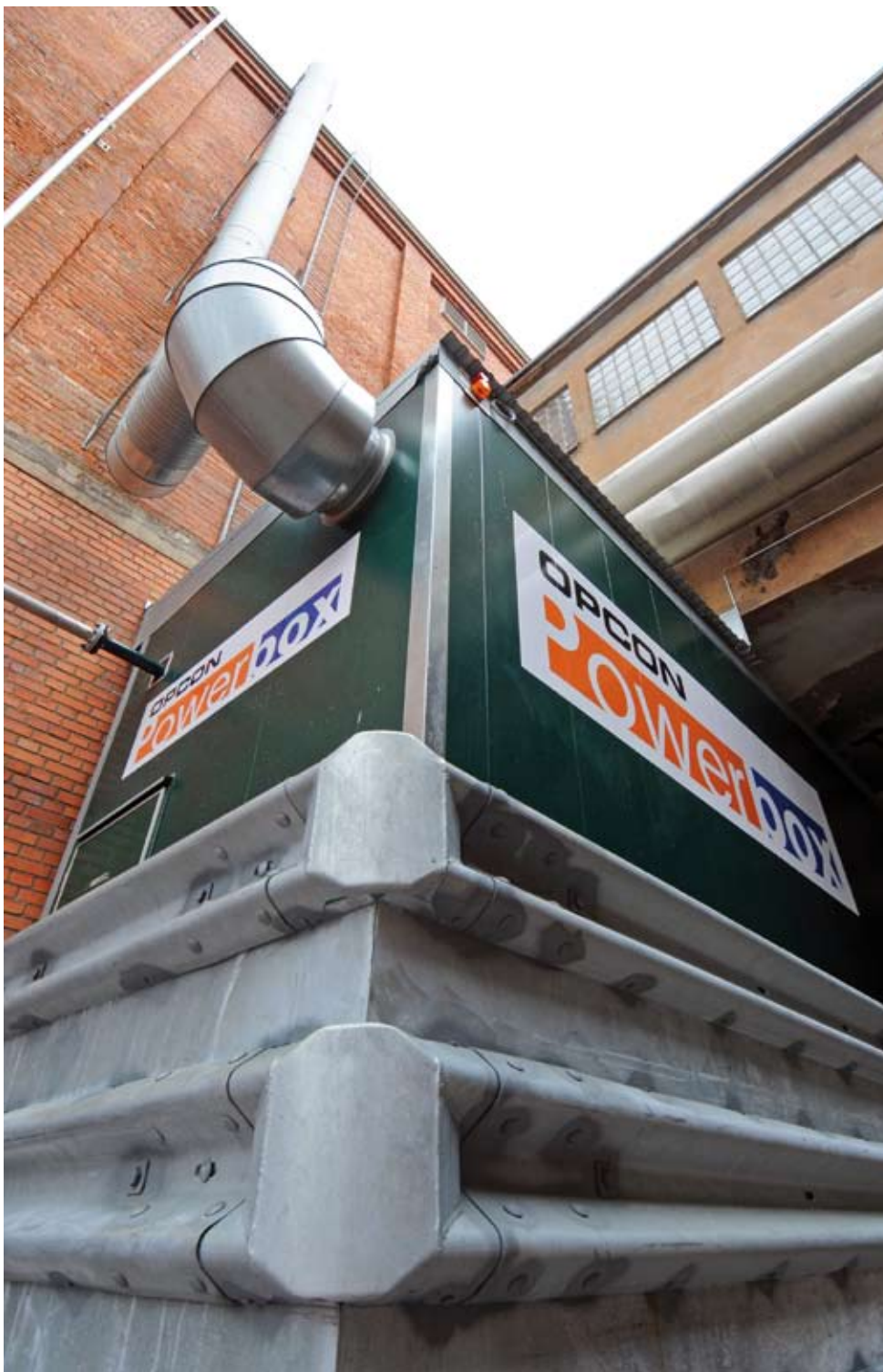
Opcon Powerbox vid Munksjö Aspa Bruk, installerad 2009.
