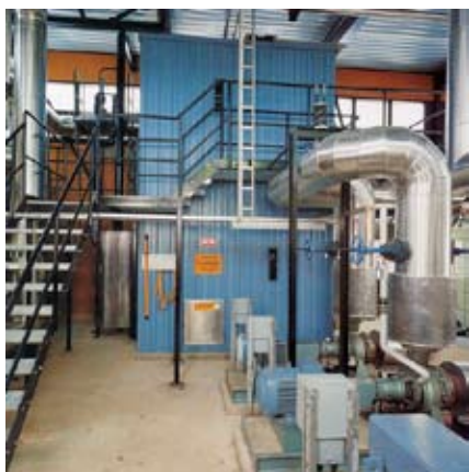
Averhoff Energi Anlæg A/S er en rådgivende totalentreprenør, der yder de danske fjernvarmeværker hjælp i forbindelse med udskiftning og optimering af anlæg
