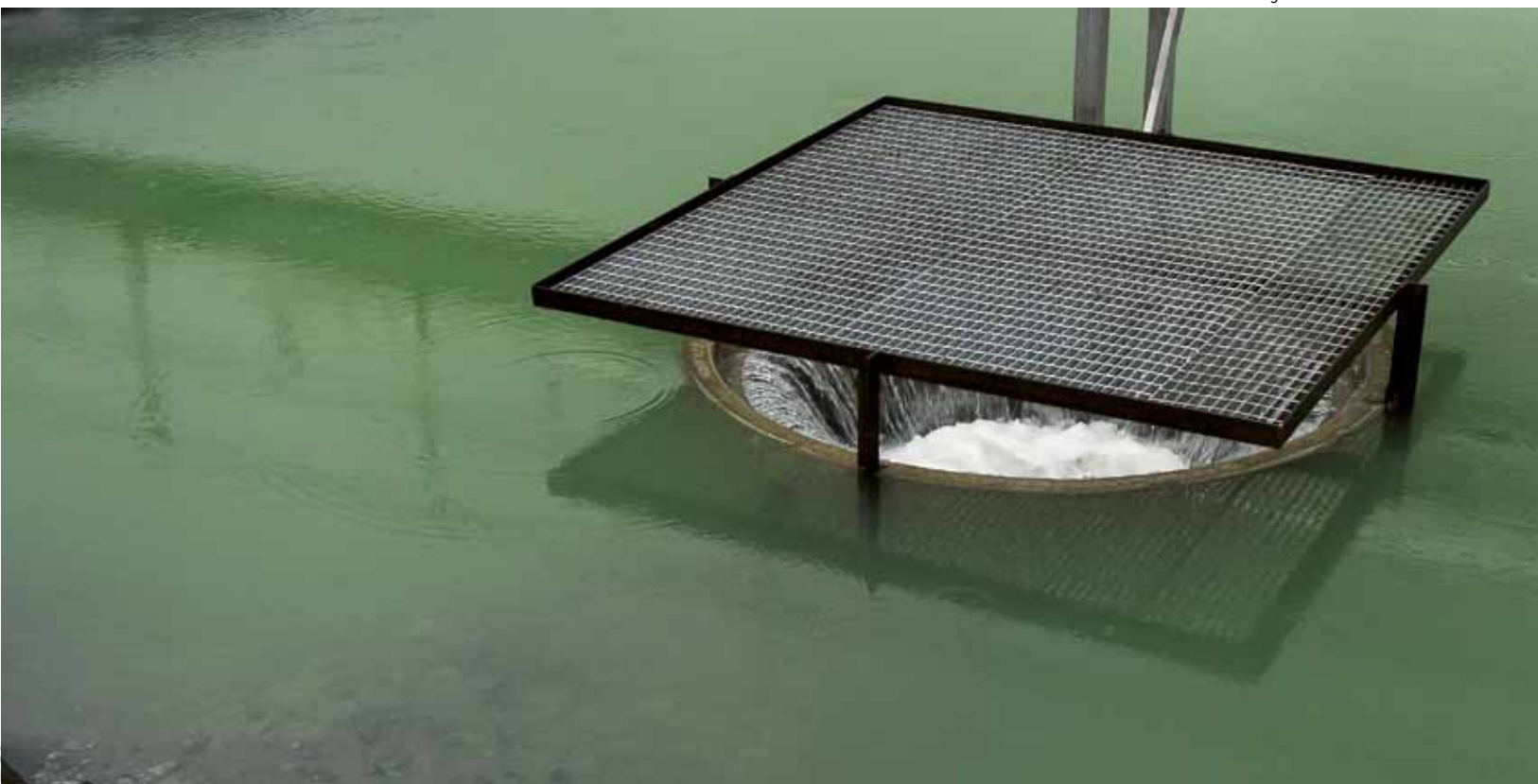
Utflöde av renat vatten från sedimentationsbassäng.
