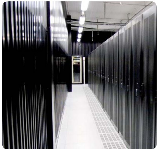
Phoneras datacenter i Hammarby Sjöstad.
