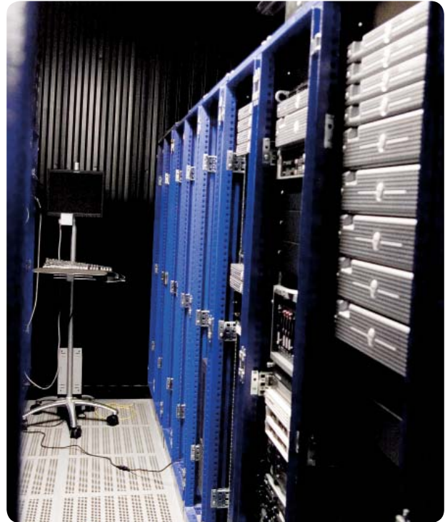
Bild från Phoneras datacenter i Stockholm.
