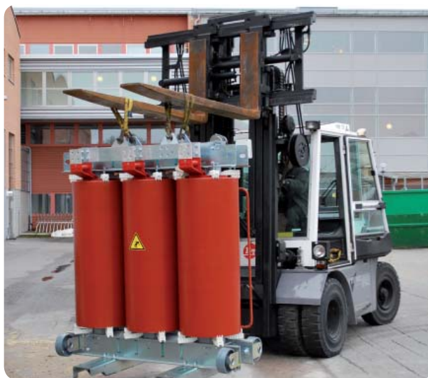
En av anläggningens två energieffektiva transformatorer körs in för montering.
