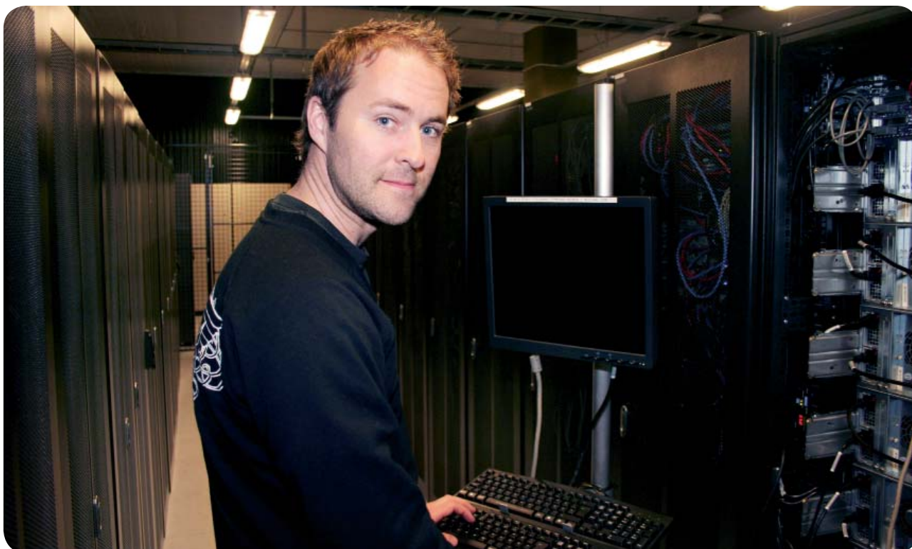
Jens är tekniker och webbdesigner. Han arbetar på bilden med serverunderhåll i ett av Phoneras datacenter.
