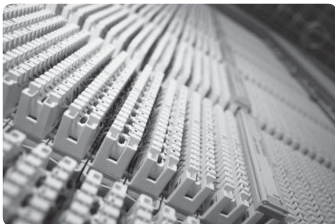
Detalj från telestation ifrån vilken Phonera levererar ADSL.
