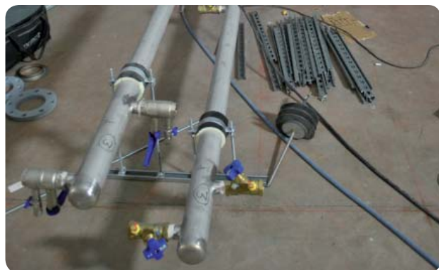
Detaljbild av kylrör.
