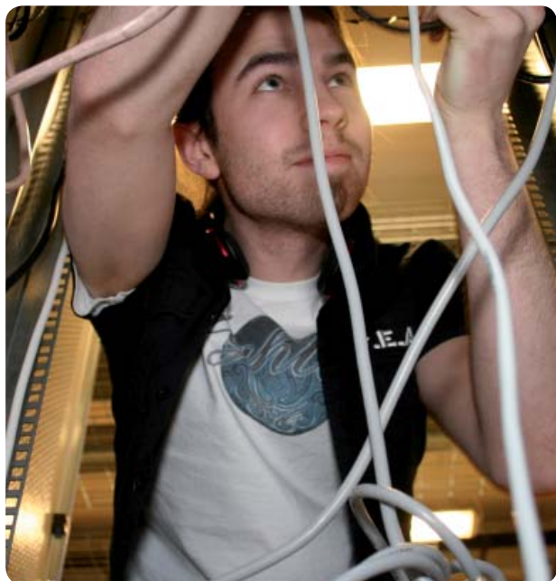
Christoffer kopplar in en server i ett av Phoneras datacenter.
