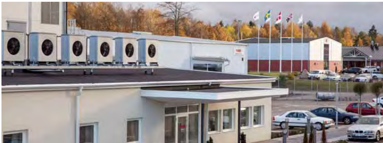
Under 2012 installerades en helt ny värmepumpsanläggning på Värmepumpcenter i Markaryd. Den installerade värmeeffekten uppgår till 180 kW och energin tas dels ur fem borrhål, som är vardera 160 meter djupa samt dels ur uteluften genom sex stycken NIBE AMB-aggregat på vardera omkring 20 kW. Dessutom återvinner anläggningen energin som används vid driftprovning av produkter i tillverkning.
