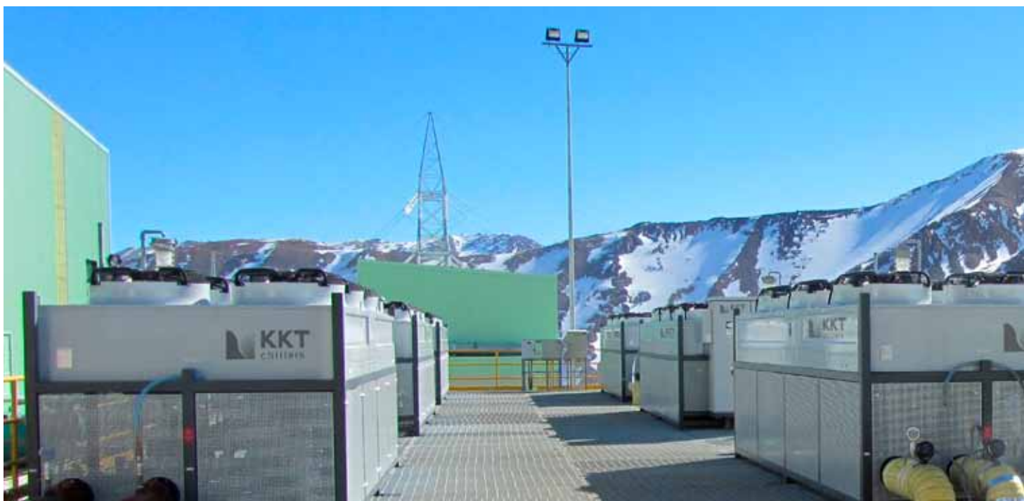
Tyska KKT levererar kylanläggningar för industriellt bruk, i detta fall avsedda för kylning av elektriska motorer och utrustning för varvtalsreglering i en gruvanläggning i Los Brances, Chile.
