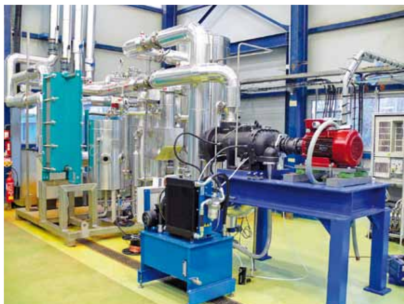
Kompressor från Opcon/SRM i en av energibolaget EDF:s värmepumpinstalleringar i Frankrike.
