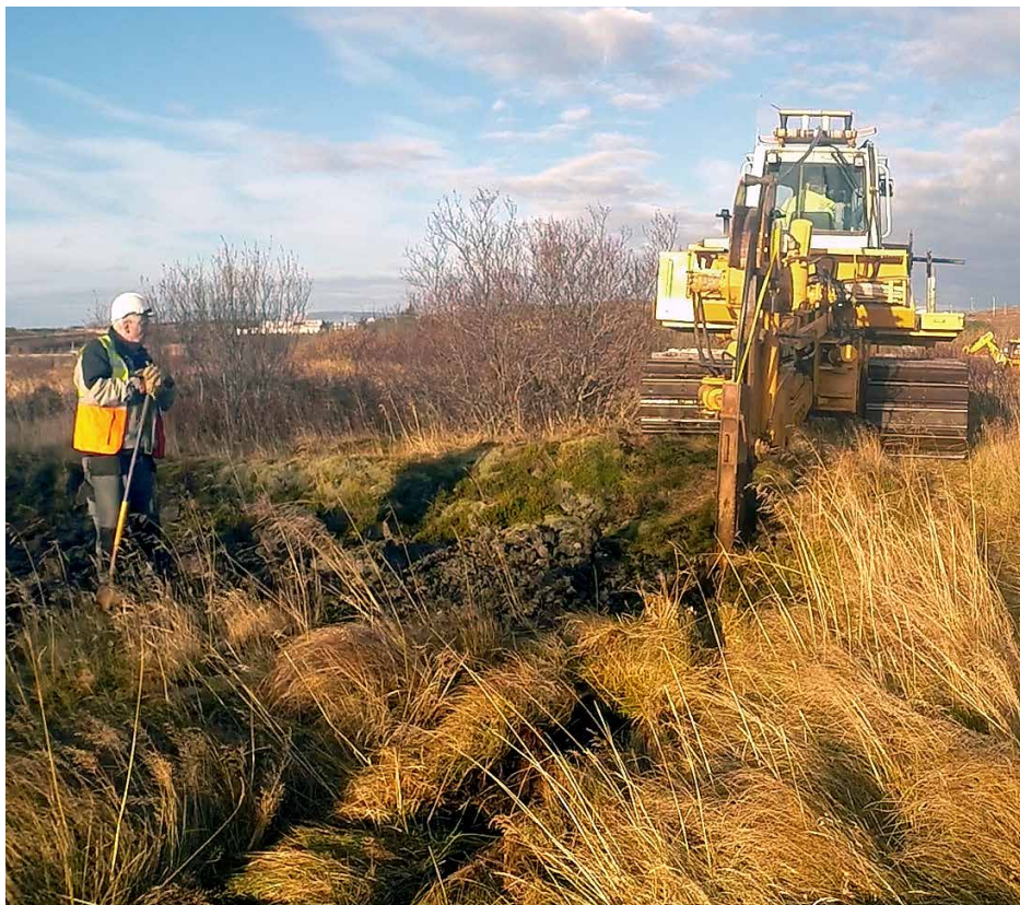
Mynd 9. Elliðavatnslína lögð í jörð á haustdögum 2014. Þess var gætt að nýta tækni og verklag til að draga úr raski meðal annars á grónu landi. Ljósmynd: Ingvar Jón Ingvarsson.
