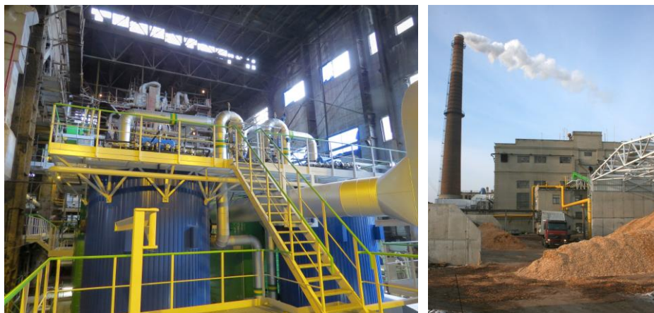
Nuotr.: naujieji vandens šildymo katilai ir biokuro sandėlis Petrašiūnų elektrinėje
