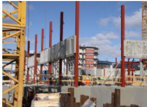
Kista Isafjord 1: Pågående ny- och ombyggnation av ett nytt kontorshus till Ericsson om totalt 36 tkvm. Inflyttning är beräknad till april 2012.
