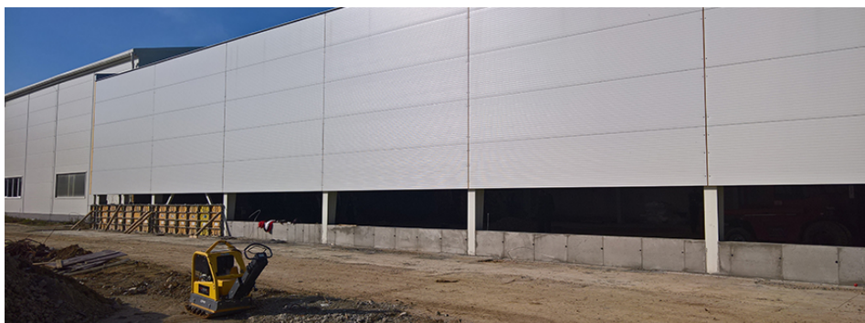
Kluster Centraleuropa: Utbyggnad med 1 400 kvm färdigställs under Q4/16
